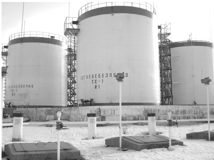
Рис. 6.2. Зовнішній вигляд резервуарів на складі зберігання палив
